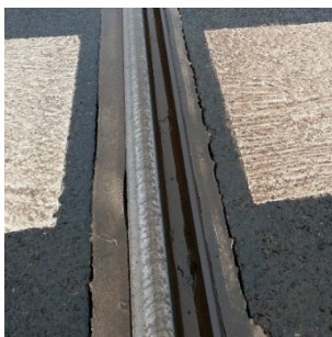
Stand der Technik: Schadensbild durch abgelöstes Fugenmaterial
